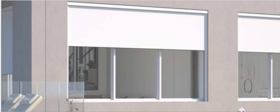
Tende a rullo da esterno installate a protezione di ampie vetrate.
